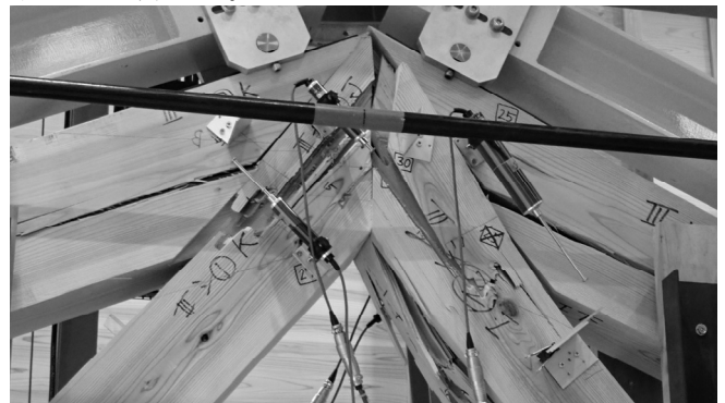
図 4. 合掌の上弦材-斜材仕口の破壊状況
