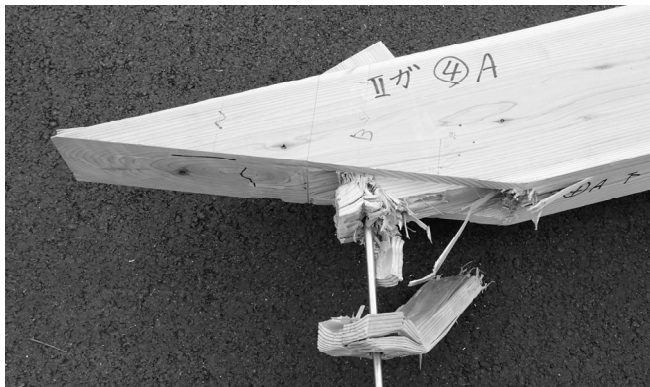
図 3. 合掌尻の上弦材下端部の三角ホゾの破壊状況
