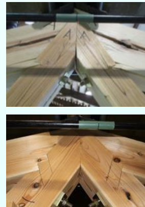
写真-3 トラス頂部の状況 上:初代型、下:改良型
